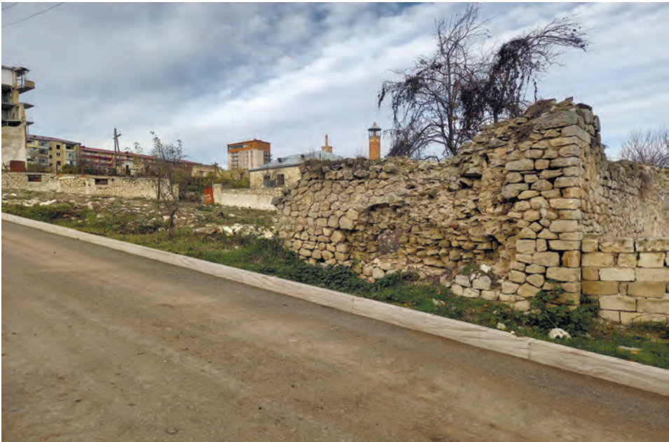
Mir Həsən Vəzirov küçəsi. Yaşayış evi. XIX əsr memarlıq abidəsi idi. İşğaldan sonra erməni işğalçıları tərəfindən tam dağıdılmışdır.
