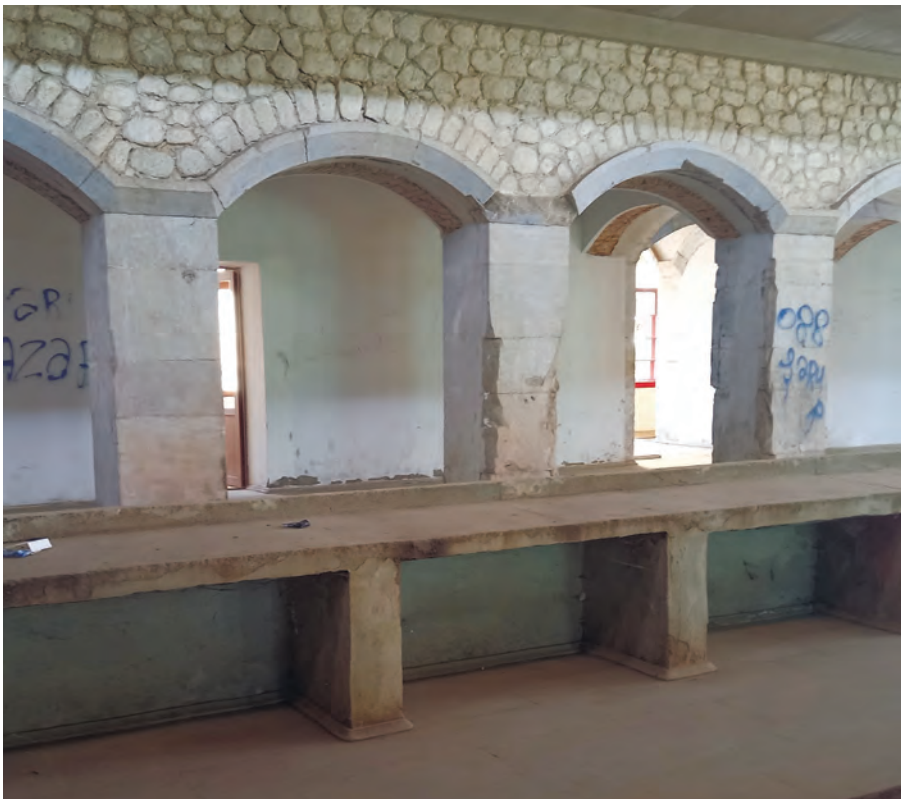
Məşədi Şükür Mirsiyab oğlunun karvansarayının interyeri. XIX əsr memarlıq abidəsidir. Şuşa şəhəri işğal edilənə qədər bu binada kolxoz bazarı fəaliyyət göstərmişdir.
