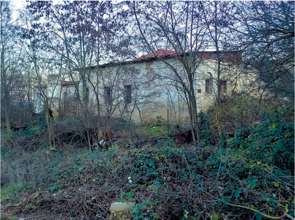
Təzə məhəllə. Yaşayış evi. XIX əsr memarlıq abidəsidir. İşğaldan sonra evin ikinci mərtəbəsi işğalçılar tərəfindən sökülmüşdür.
