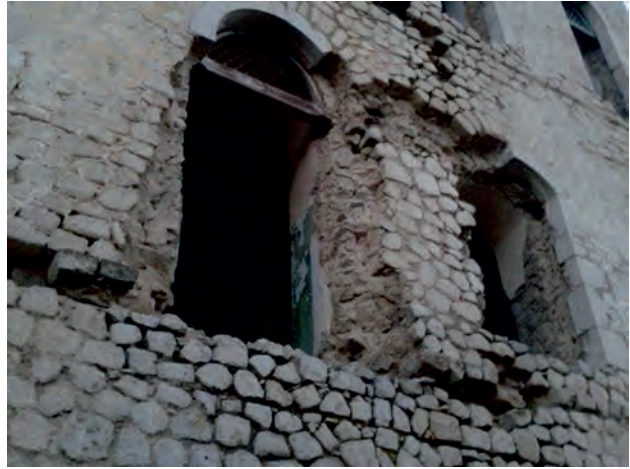
Kənar daşları ermənilər tərəfindən sökülmüş pəncərələr
