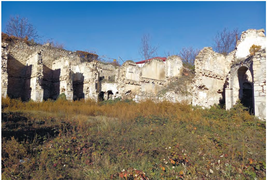
Səfərov qardaşlarının karvansarayı. XIX əsr memarlıq abidəsidir. İşğaldan sonra bu nəfis memarlığı olan 3 mərtəbəli bina işğalçılar tərəfindən dağıdılmışdır. Hazırda binanın yalnız birinci mərtəbəsinin xarabalıqları qalıb.
